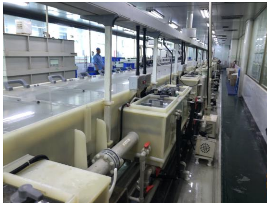
空壓機熱能回用於沉錫線的溶液加熱
